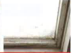
枠の腐食・劣化
