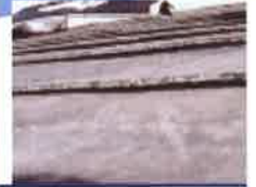
屋根材の浮き
